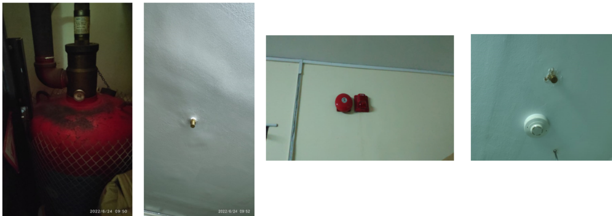
Gambar 3.6.4 Fasilitas Pendukung Fire Suppression, Sprinkle, Alarm, dan Smoke Detector
