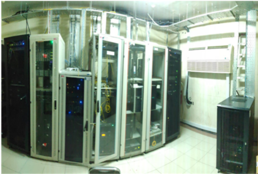
Gambar 3.6.2 Kondisi Ruang Server di Pusat Data Diskominfo Pemko Batam
